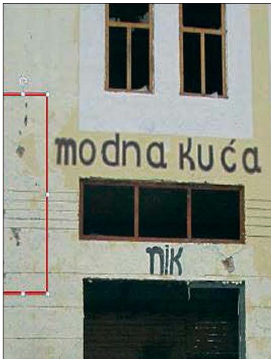
Изглед трговине „НИК“ након опита 2016. год. Оштећења окружена црвеним квадратом.
